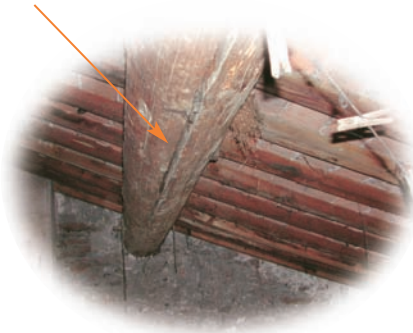
Fessura verticale: il modulo di resistenza non cambia
