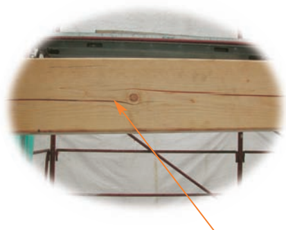
Fessura orizzontale che si sviluppa a partire da un nodo: il modulo di resistenza teorico subisce un decremento
