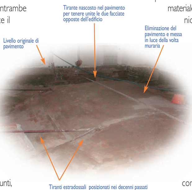
Tiranti estradossali posizionati nei decenni passati
