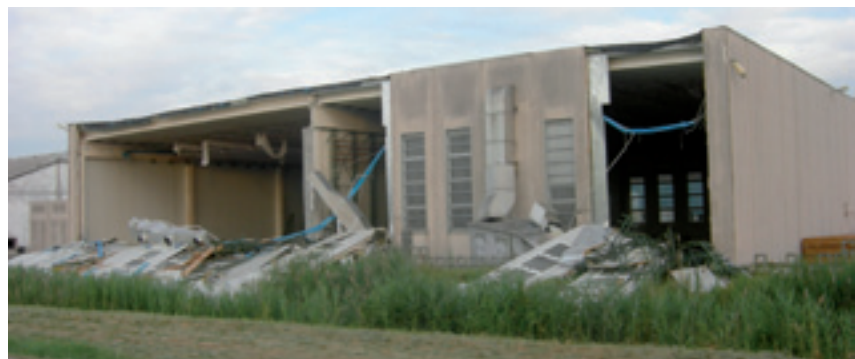
Post-sisma: errata connessione tra elementi prefabbricati
