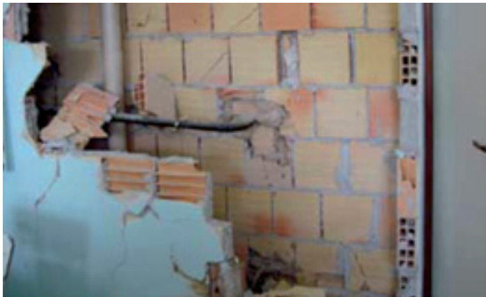
Condizione assolutamente da evitare in edifici d'importanza strategica (fonte: Siniat)
