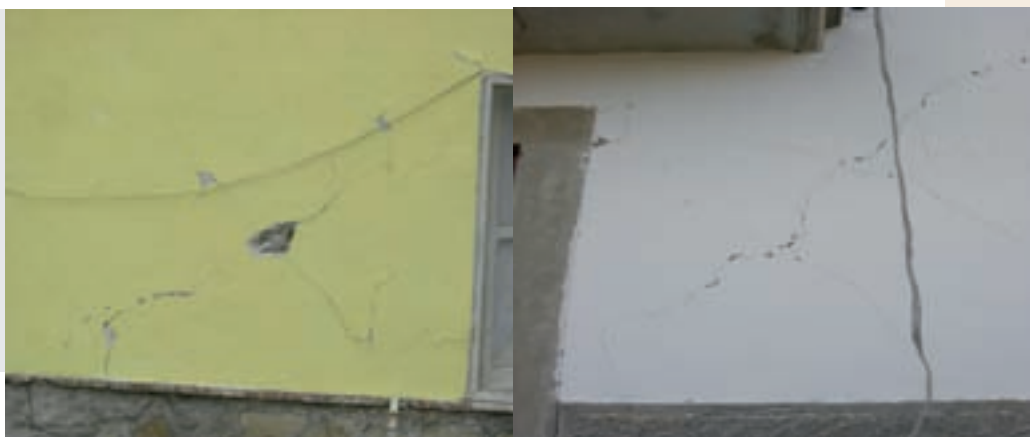
Tipiche lesioni a X sulle murature causate dal sisma e, a destra, lesione orizzontale a 30 cm dal soffitto causata dallo scorrimento relativo tra trave fuori spessore in c.a. e tamponamento.
