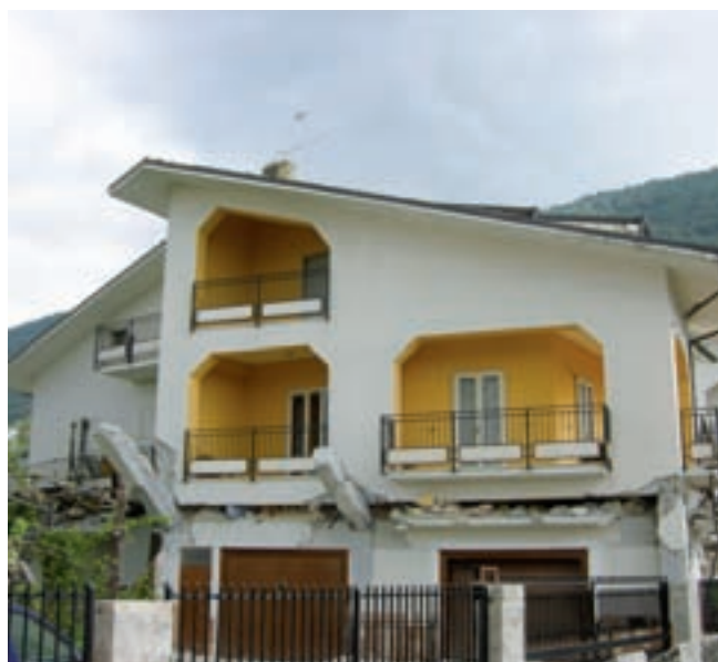
Rottura della costruzione con espulsione esterna dei pilastri in c.a. e completo schiacciamento del piano primo da parte dei piani sovrastanti; l'esecuzione del nodo pilastro-trave è completamente inadeguata.
